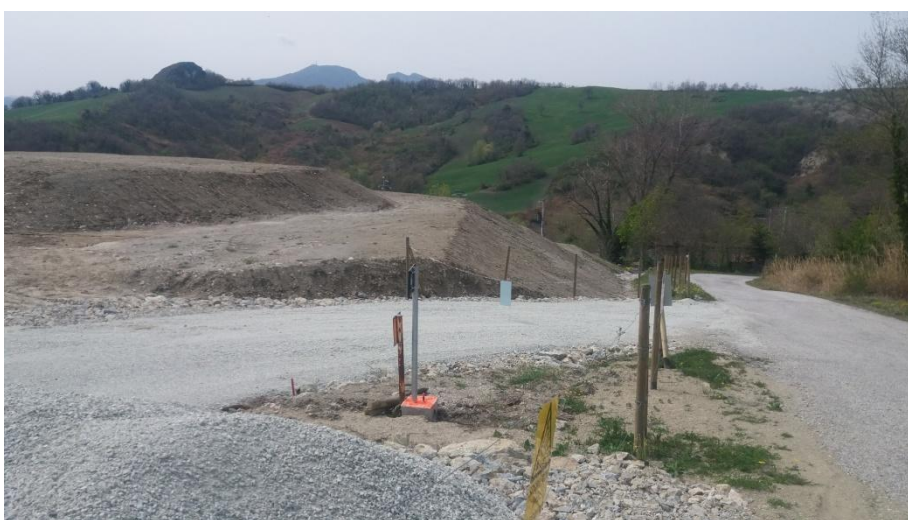
Foto 6 - interventi di sistemazione morfologica contestuali alle operazioni di scavo nel settore dove ora si concentra l'attività estrattiva.
